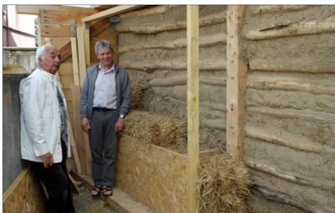
Marc Grodwohl (à gauche) avec le maire d'Ungersheim, Jean-Claude Mensch, devant le mur prototype de la future ferme du Kohlacker : des rondins de robinier et du torchis à l'extérieur, des bottes de paille pour l'isolation, qui viendront doubler les parois intérieures à ossature bois.
